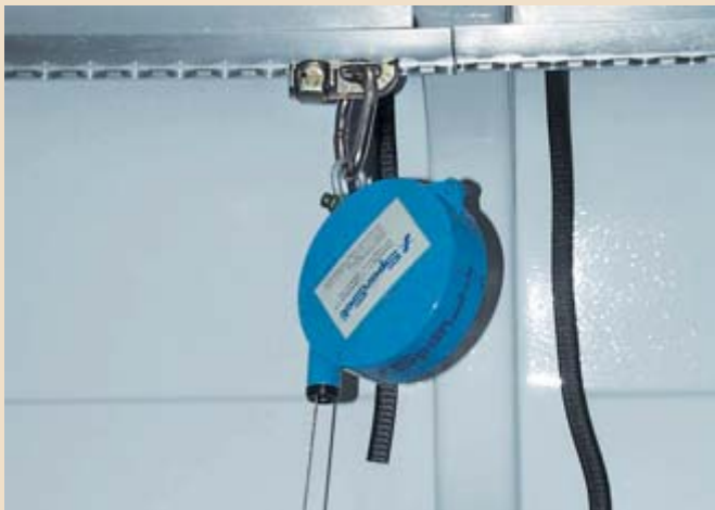
◀ Wenn das Netz nicht benötigt wird, wird es durch eine Drahtseilrolle, die in der Lochschiene am Dach befestigt ist, hochgezogen.
