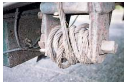
Wegen der „Luftschlaufen“ kann das Seil nachrutschen und dadurch seine Vorspannkraft verlieren.
