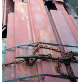
Diese Spannelemente sind gefährlich und dürfen nicht verwendet werden.
