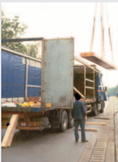
Hier musste abgeladen werden.
